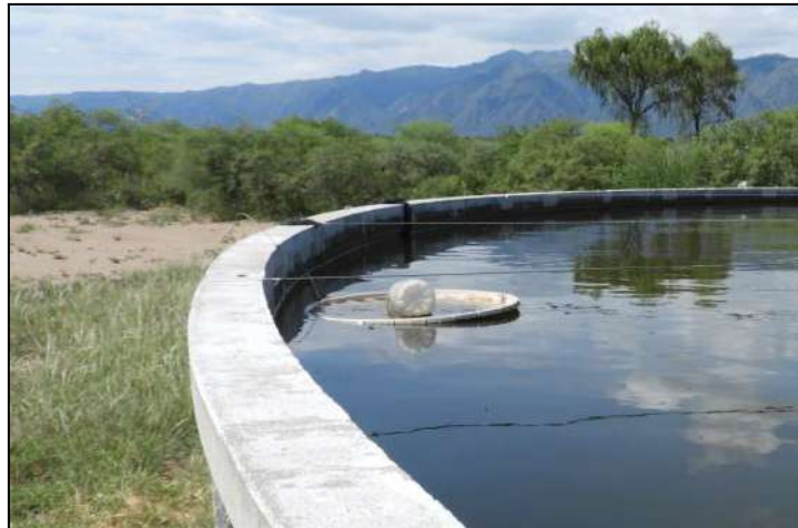
Figura 25. Tanque Australiano con dispositivo para evitar ahogamiento de fauna.
